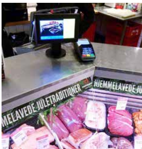
EBM har installeret 2 komplette og integrerede anlæg hos Slagteren i Højslev.
