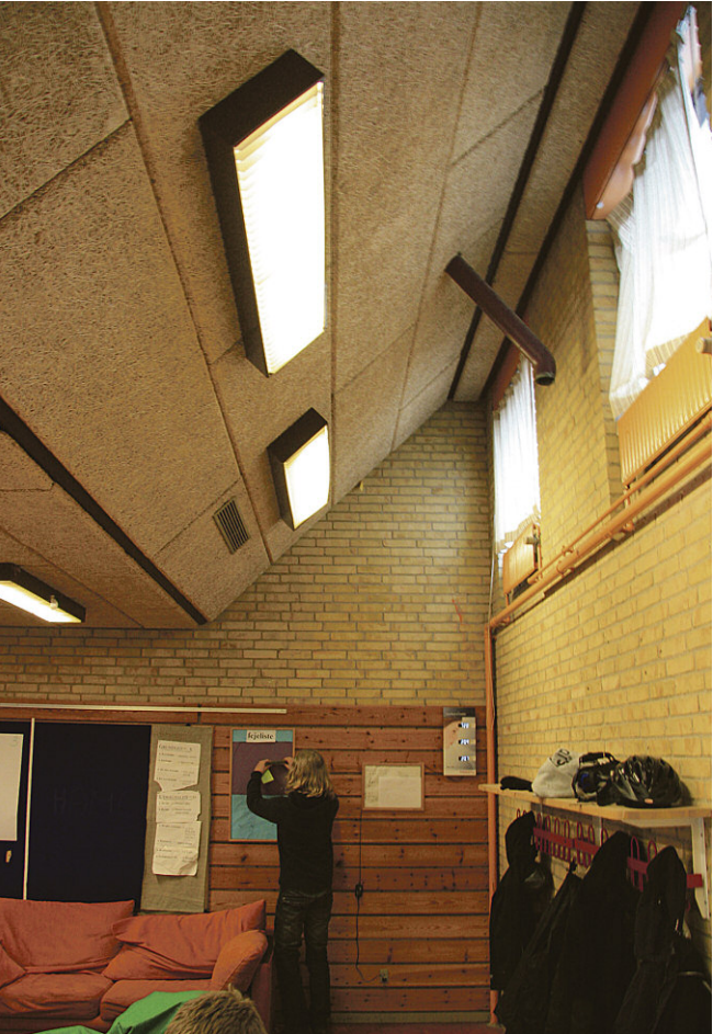
Det kræver plads under loftet at installere ventilationssystemet med større dimensioner end normalt. Men netop i Vallensbæk Kommune er der højt til loftet, når det gælder om at implementere intelligente løsninger, som kan spare energi
