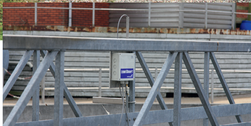
Jyllinge Renseanlæg har fået installeret to slamspejlsålere - begge med trådløs signaloverførsel fra hver sensor, monteret på runde efterklaringstanke med kørende skraberbro. Billedet viser monteringen på skraberbroen
